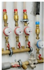
Счетчики расхода холодной и горячей воды
