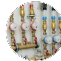
Счетчики расхода холодной и горячей воды
