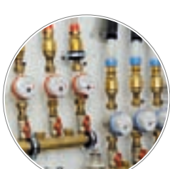
Счетчики расхода холодной и горячей воды
